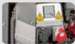
Generador: Trifásico con una base trifásica y una monofásica con disyuntor
